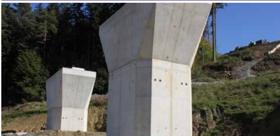
Podporni stebri bodoče hitre ceste 3RO, priključek Podgorje pri Slovenj Gradcu Foto Jože Miklavc
